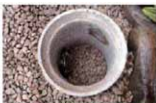
雨水浸透ます
