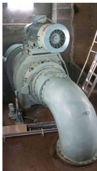
開発後発電機
